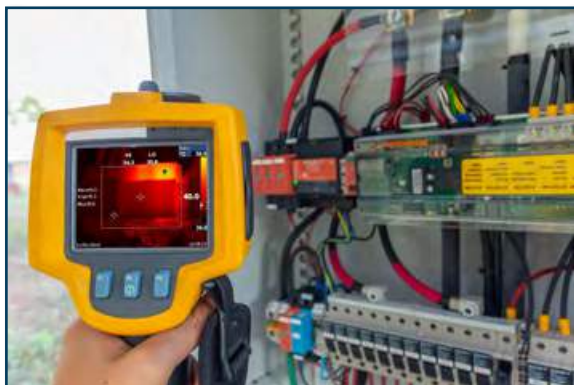
Análise Termográfica da Rede Elétrica do Fórum Trabalhista de Goiânia
